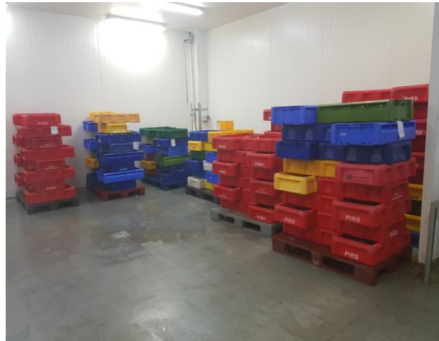
Fot.2. Komora chłodnicza z instalacją chłodniczą freonową - magazynowanie rozmrożonego surowca.
